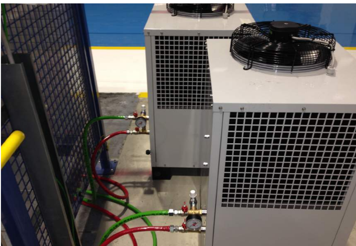
Installazione su linea di saldatura automatica – Automatic welding plant installation
